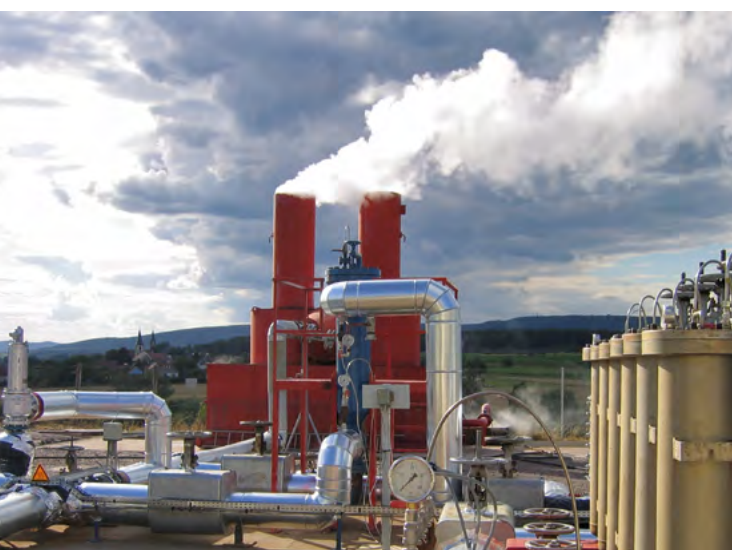
La centrale de géothermie profonde de Soultz-sous-Forêts. © BRGM
